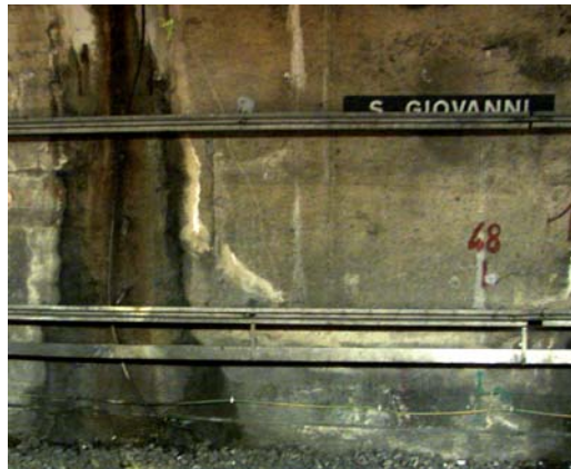
Die Metrostation „San Giovanni“, Schäden von einem Wassereinbruch, darunter „kleine“ Stromkabel
